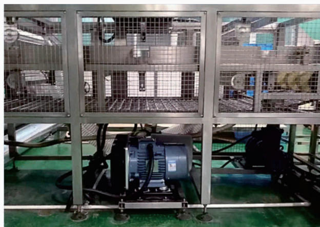
替代環形高壓高壓風機的乾燥系統後
