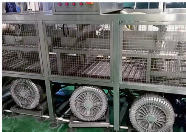
替代環形高壓高壓風機的乾燥系統前
